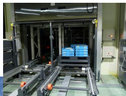
第二冷凍センター のユニット式自動 倉庫（右）
